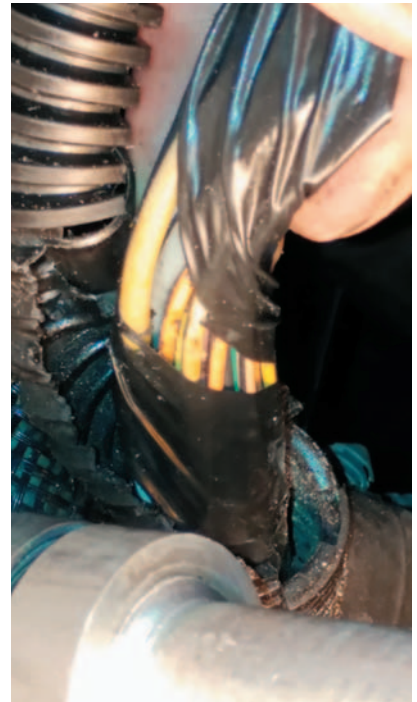
CHAFED WIRING INSULATION
